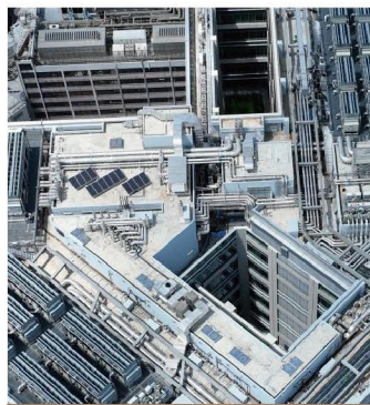
天面制冷机房
