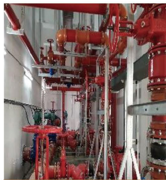
消防水泵模块
